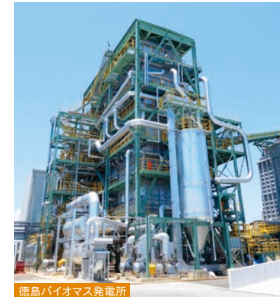
徳島バイオマス発電所
