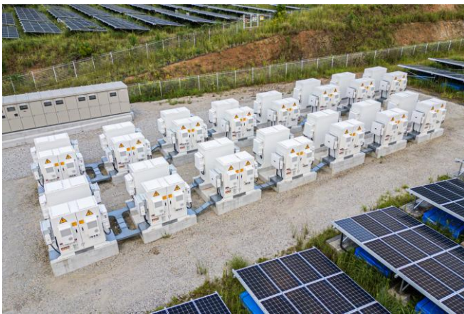
太陽光発電所に併設された蓄電池
