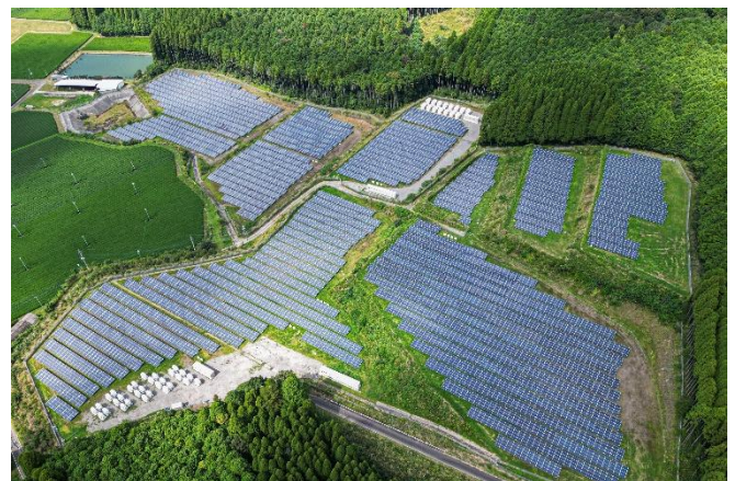
No.188-1 T&M 鹿児島県湧水町木場メガソーラー（第 1 発電所）
