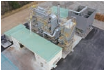
福島平田村バイオマスパワー2号機
