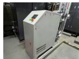
熱回収システム
