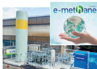
▲知多LNG共同基地で2024年3月に運転を開始したe-メタン製造実証設備
