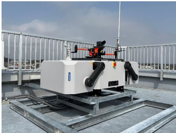
一宮町役場の屋上に設置されているドローンポート
