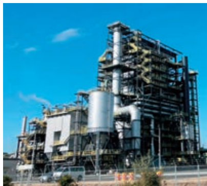
バイオマス発電プラント
