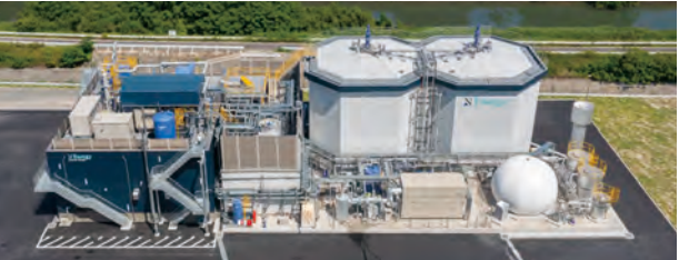
熊本西部バイオガス発電所
