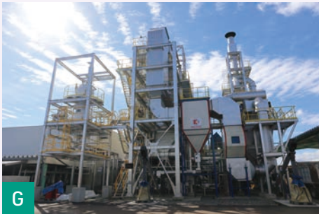
G 錦町2MW木質バイオマス発電所 (発電容量2.0MW)
