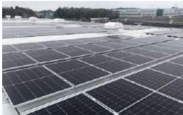
伊藤喜オールスチールの太陽光パネル
