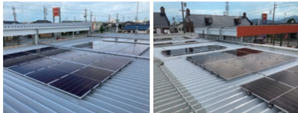
津鋼管前営業所／津観音寺営業所の太陽光パネル
