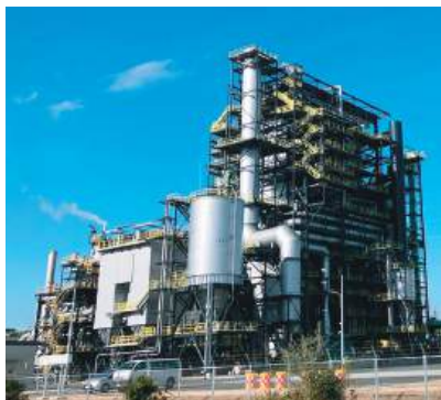
バイオマス発電プラント
