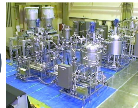
固液混合分散システム
