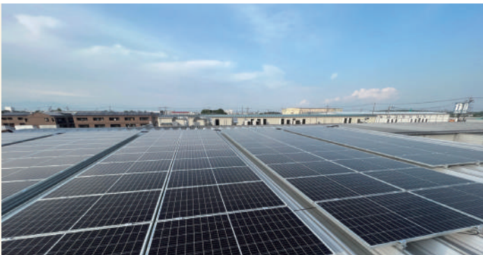
（株）ジョッキ 埼玉工場の太陽光パネル
