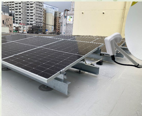
屋上太陽光発電設備
