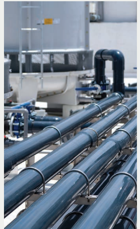
冷凍空調工程 Air Conditioning project
