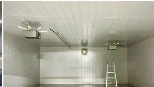
吸気口 (有圧換気扇) + 加湿装置
