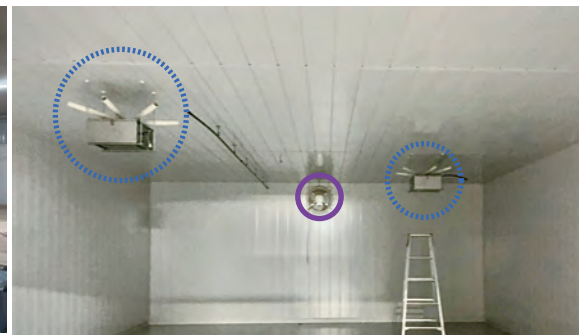
栽培室吸気口 (有圧換気扇) + 加湿装置
