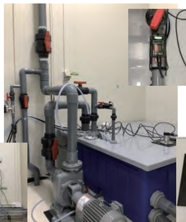
養液調整タンク室
